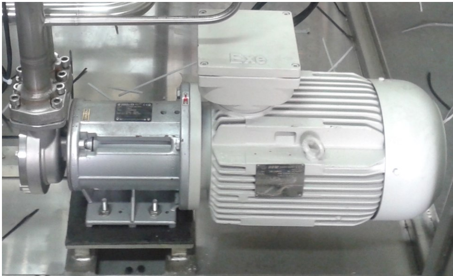
Pic.8 格兰富磁力泵 Grundfos magnetic pump
