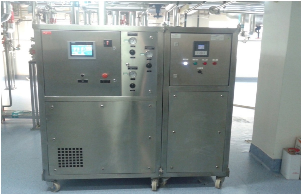
Pic.12 控制箱 Control box
