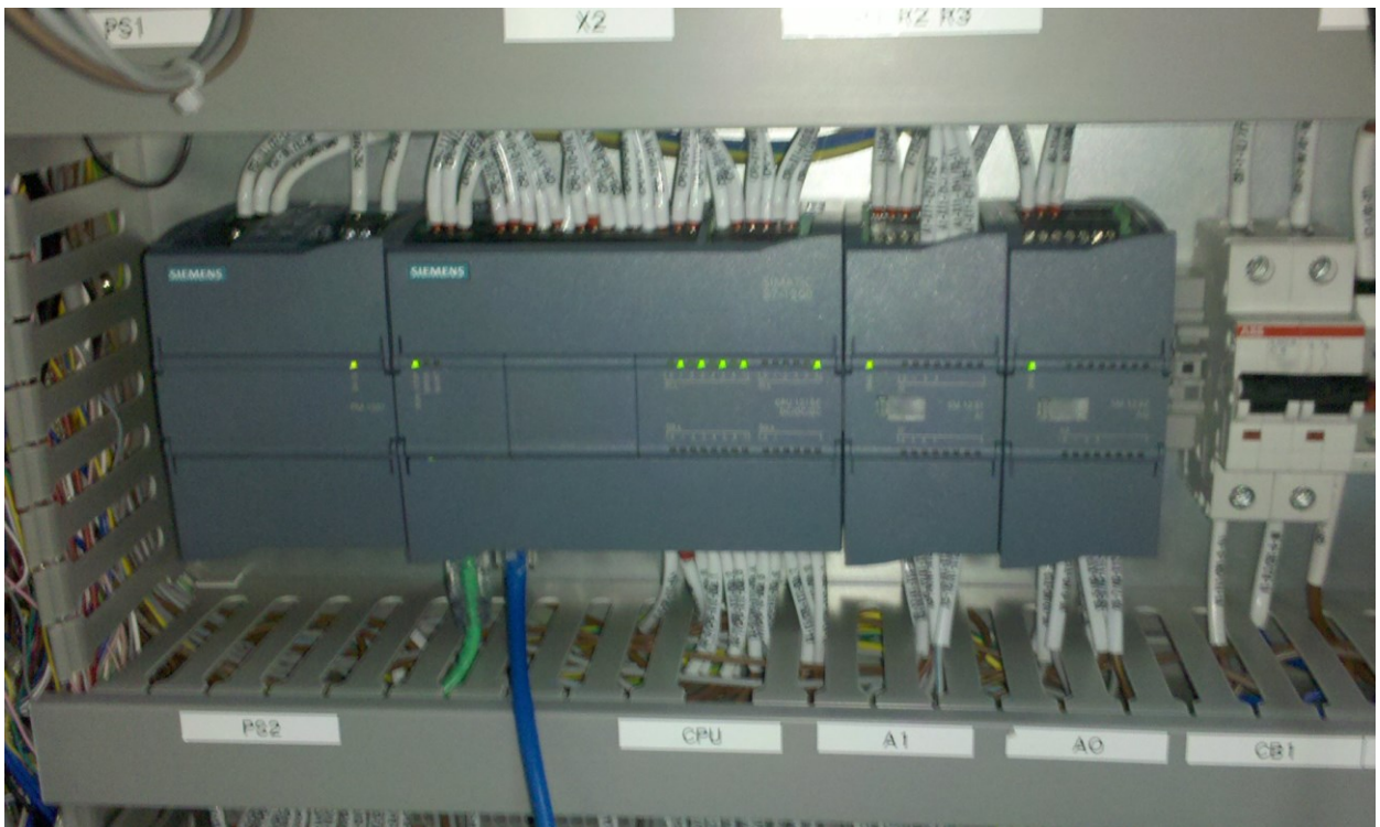
Pic.11 西门子控制系统 SIEMENS control system
